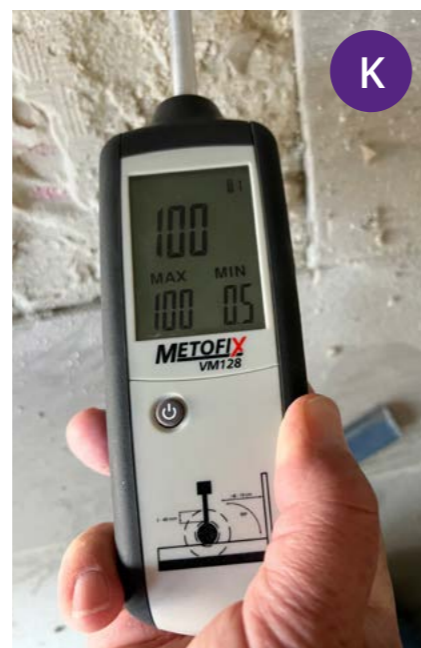
K Vochtmeting ter hoogte van de afvoergoot. Hier krijgen we waarden van 100% vochtigheid.
