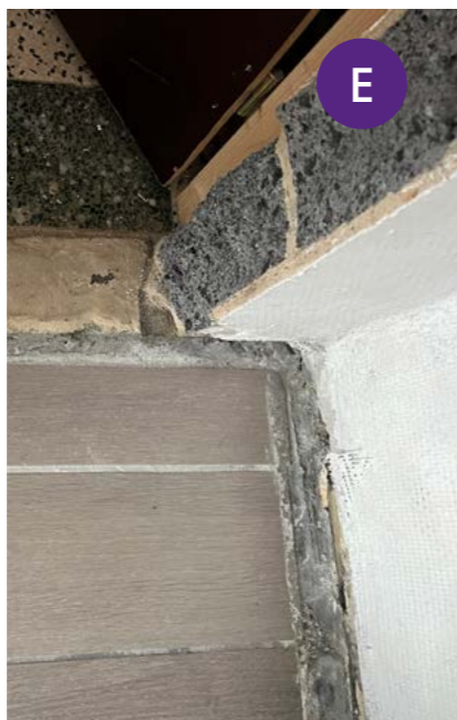
E Ontbrekende dilatatievoeg in de aansluiting van de vloer naar de muur
