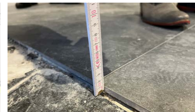
Waterlek onder tegelwerk verstoort openingsdatum winkelpand
